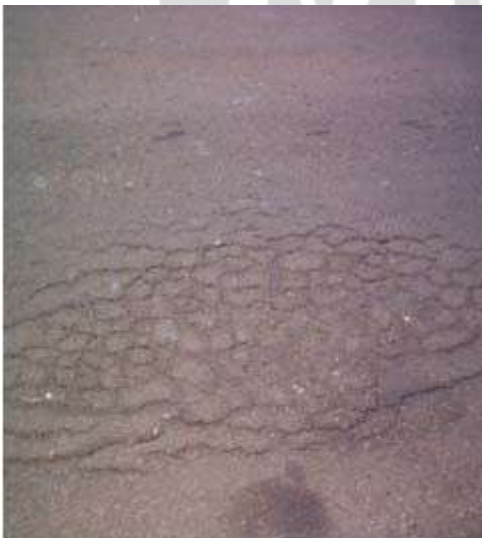
Fig : Alligator cracks
